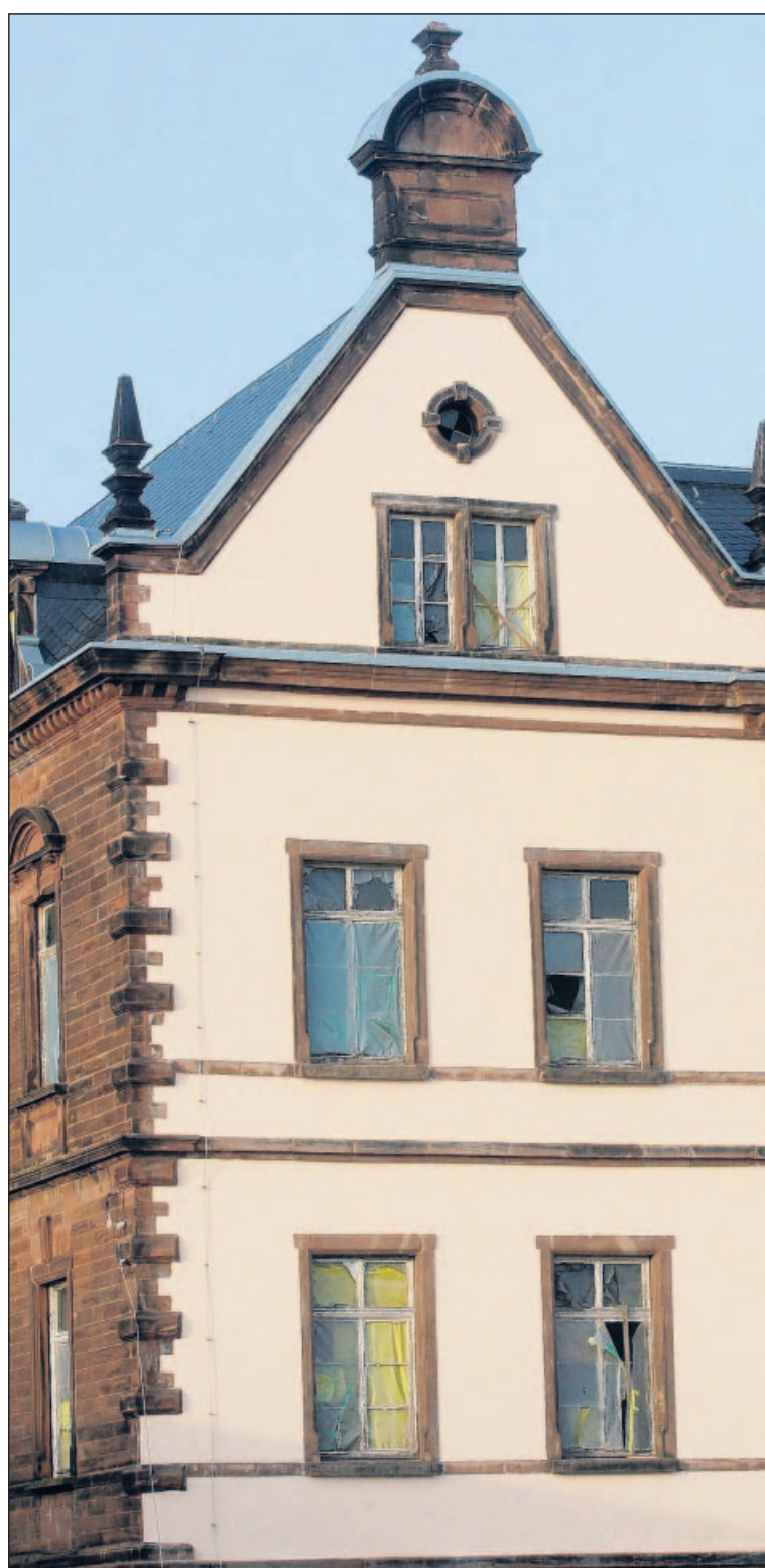
Die Fenster des Hilgardhauses werden als Nächstes saniert, sagt Hausbesitzer Manfred Schenk. FOTO: FÜSSLER
